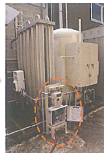
SGU-4を設置したところ
